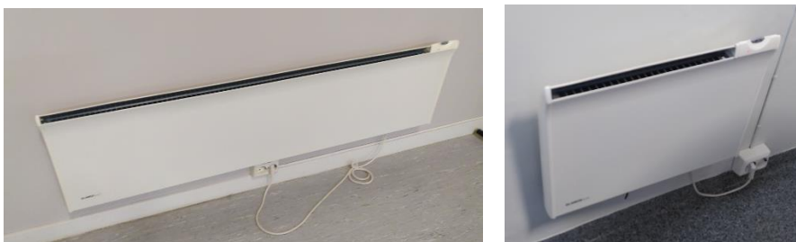
Glamox panelovner på rom 163A og 155N
