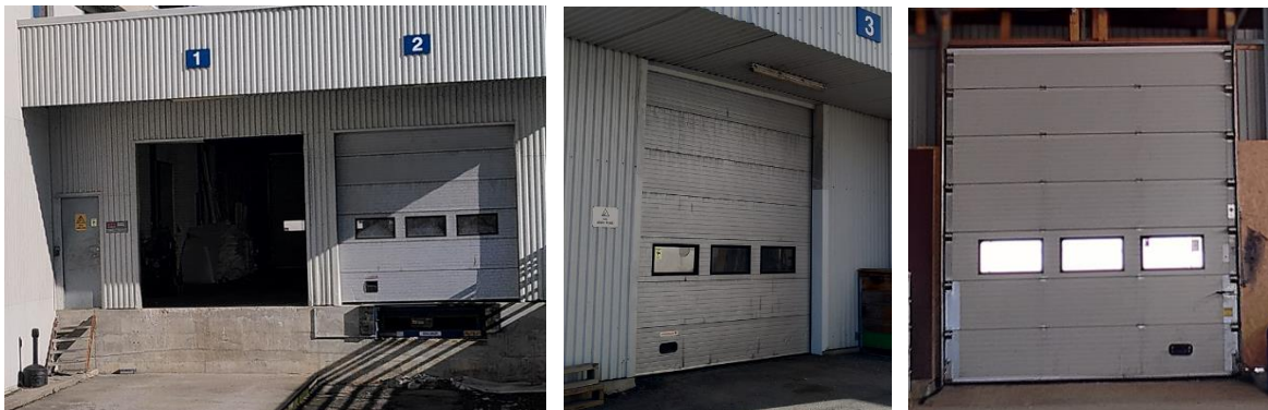
3 stk Windsor porter i mottakshall (A-170). Port 1 + 2 har mål 3 x 3,55 m
