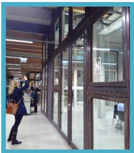
Ombruk av vinduer i innervegg mot møterom 10
