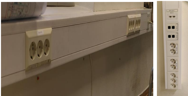
Kabelkanaler i adm bygg.
