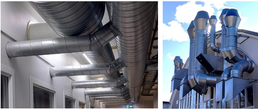
Ventilasjonsrør i gang 191, og avkast i fasade øst
