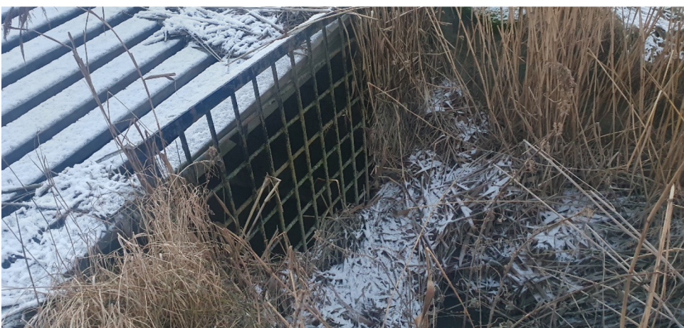
Fig 17 – Rist foran utløpet av dammen, delvis tilstoppet.
